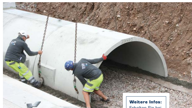
Das erste Bauteil des Sickertunnels wird in der Baugrube platziert. (Mall GmbH)
