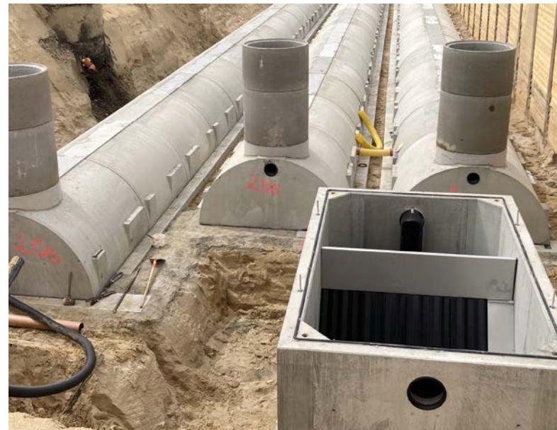
Die drei miteinander verbundenen Sickertunnel können bis zu 145 m 3 Wasser aufnehmen. Im Vordergrund der Lamellenklärer zur Vorbehandlung des Regenwassers. (Mall GmbH)
