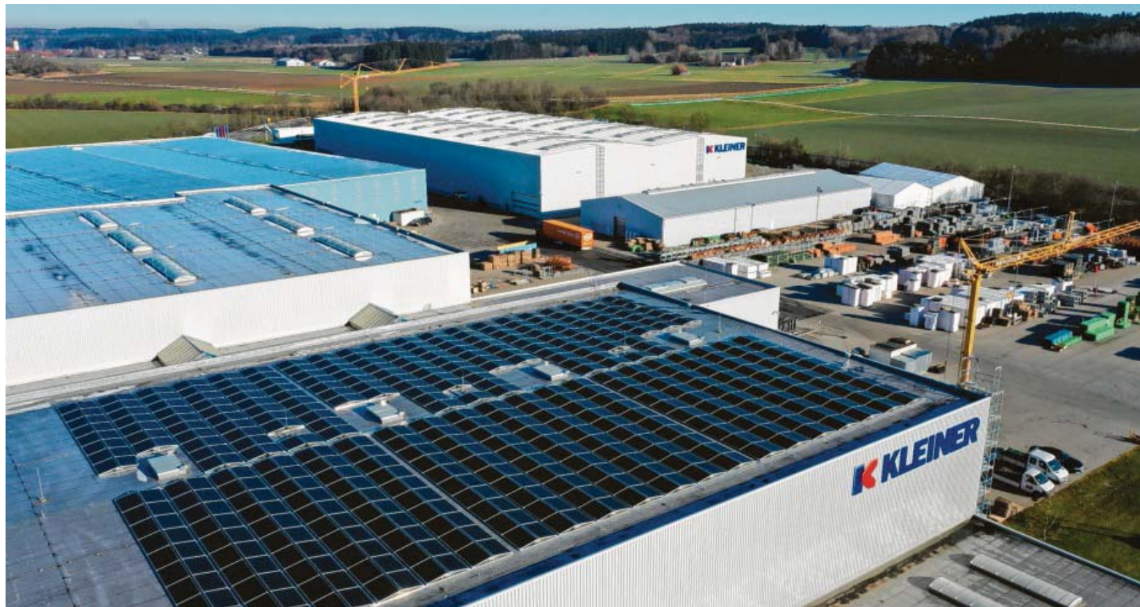
Auf dem Flachdach des Logistikzentrums der Firma Kleiner in Mindelheim arbeitet seit einiger Zeit eine moderne Photovoltaikanlage. Foto: Hartmann (Firma Kleiner)
